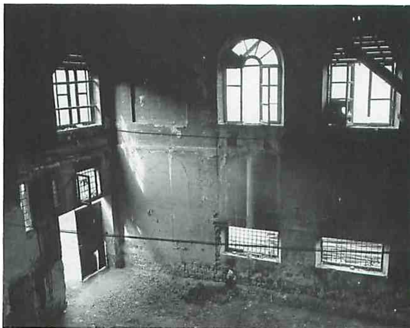
Il grande spazio 'industriale' della distilleria prima del crollo della copertura.
